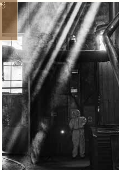
《清理配电箱》袁程 胶州公司
